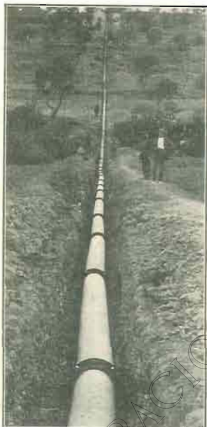
CONDUCCIÓN DE AGUAS EN CERVERA (Lérida) 1065 metros longitud. - 250 cm diámetro. - 10 atmósferas
