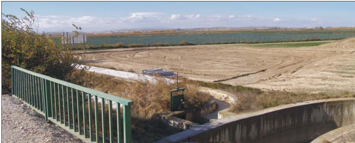
Construcción de la EDAR de Pradilla de Ebro, al estar localizada en zona inundable fue necesario elevar el terreno para salvaguardarla de las riadas.
