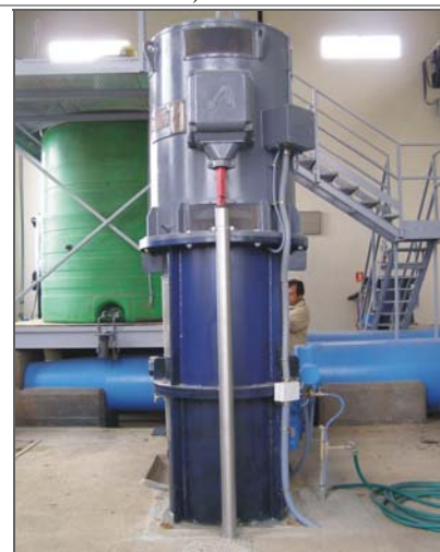
Instalaciones de la estación de bombeo de la comunidad de regantes Las Lomas en Quinto de Ebro
