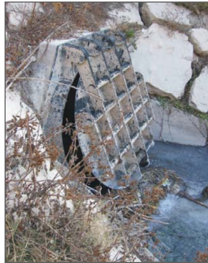
Clapeta para aguas pluviales de la conexión de las aguas residuales del polígono de Malpica a la EDAR de la Cartuja. El día de la visita hay una fuga de agua.
