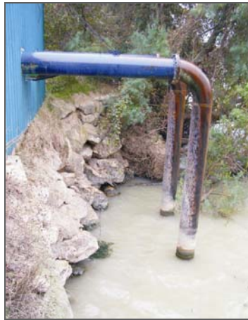
Estaciones de bombeo comunidad de regantes de Murillo de las Limas I (170 l/s) y Raso (1050 l/s)
