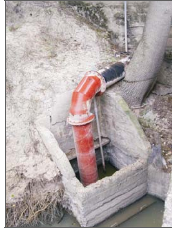
Estaciones de bombeo comunidad de regantes de Murillo de las Limas I y Raso
