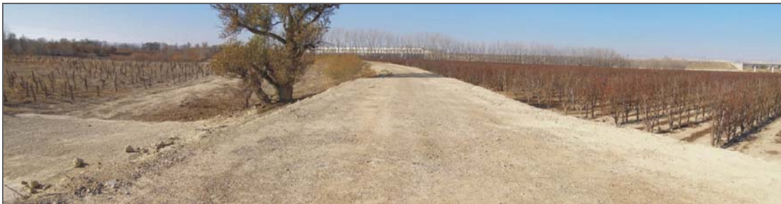
Punto de rotura de mota en la avenida de 2007 sobre la margen izquierda del río, en las inmediaciones de Aguilar del Ebro en Osera de Ebro.
