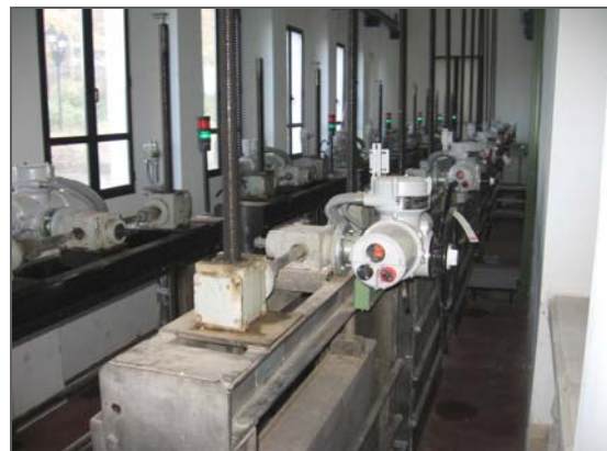
Compuertas canal de derivación del canal de Lodosa
