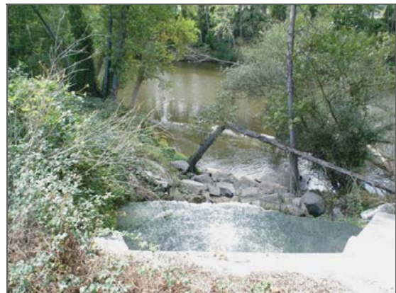
Desagüe EDAR de Miranda de Ebro
