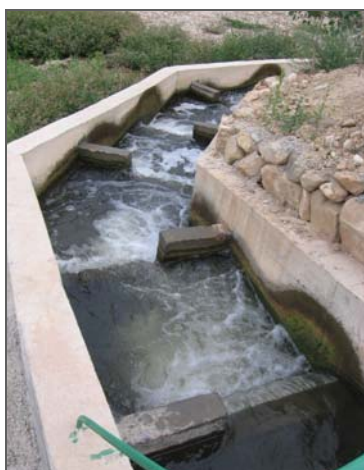
Azud central hidroeléctrica El Barco, escala de peces
