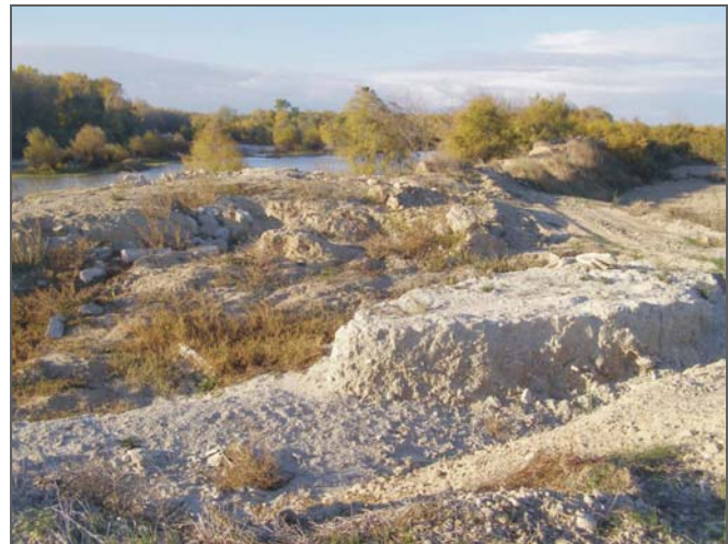
Punto de salida del río desde la llanura de inundación durante la avenida de 2007 sobre la margen izquierda en el termino de Novillas. Esta mota está pendiente de ser reparada.
