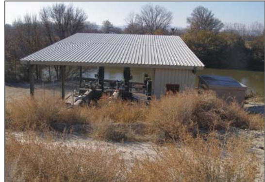
Elevación de agua de la comunidad de regantes de Osera de Ebro
