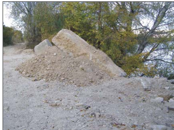
Punto de rotura de mota en las avenidas de 2003 y 2007. Inundó Pontoneros
