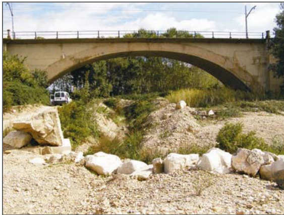
Detalle de la mota rota por la avenida.
