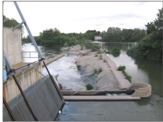
CH. Alcanadre II, robo de hilo de cobre en 2006, acabo con el vertido de aceite al canal de Lodosa
