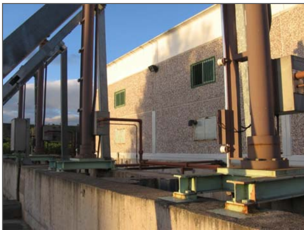
Central hidroeléctrica de Elciego, no hay cumplimiento del caudal ecológico
