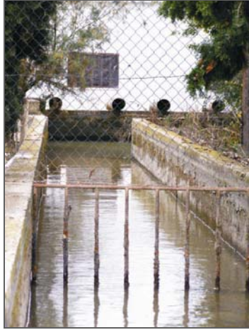
Bombeo de la comunidad de regantes de Murilla de las Limas II (545 ha), cuenta con 5 equipos de elevación, una averiado y una de reserva (700 l/s).
