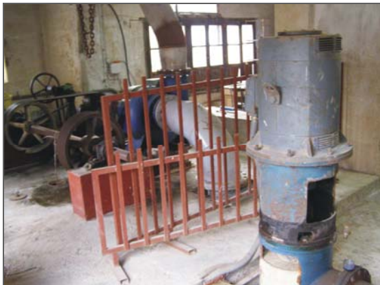
Cuarto de maquinas de la comunidad de regantes de Gelsa para impulsar el agua a una acequia elevada
