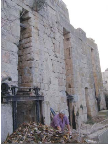
Caja de norias de la Casa del Molino, esta estructura data del siglo XVI, evidencia de los sistemas de aprovechamiento hidráulico en la ribera baja del Ebro
