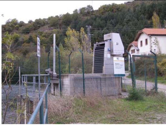
Bombeo del río Araquil a la estación potabilizadora de las aguas procedentes del Manantial de Arteta. Con la construcción del Canal de Navarra, este bombeo no se usa y la Comarca de Navarra ha dejado de ser usuario del embalse de Urdalur que soltaba agua para que fuera bombeada en este punto. A la derecha central hidroeléctrica de Eguillor
