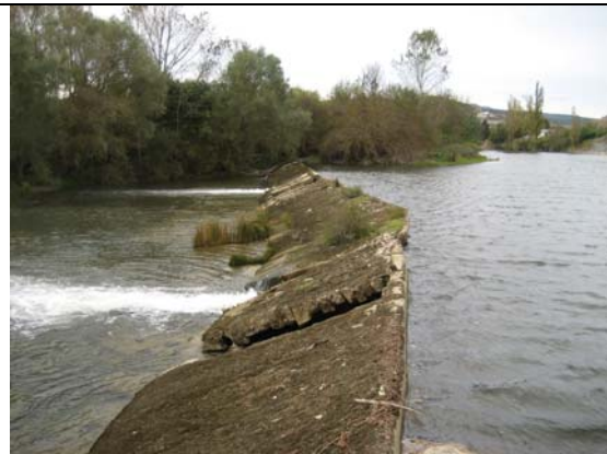
Azud del molino de Artazcoz. Derivaba agua por margen izquierda a un molino que hoy en día está en ruinas
