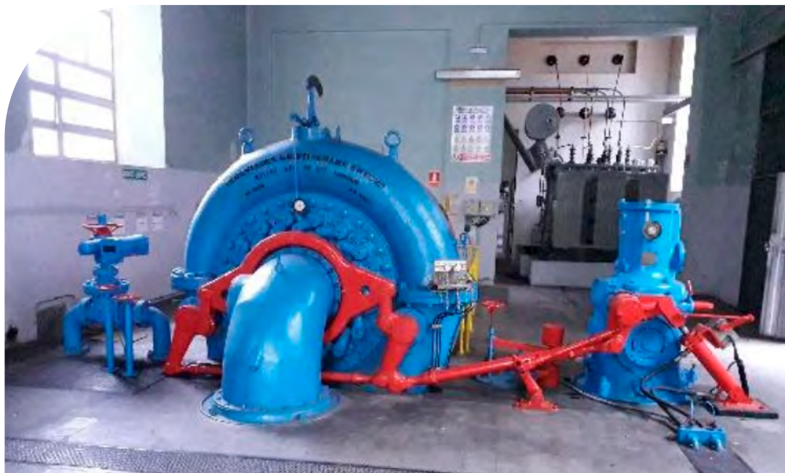
Turbina de la central de Castillonroy
