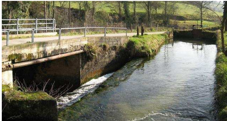
Imagen 17. Salida de agua de la Central Hidroeléctrica de Patala
